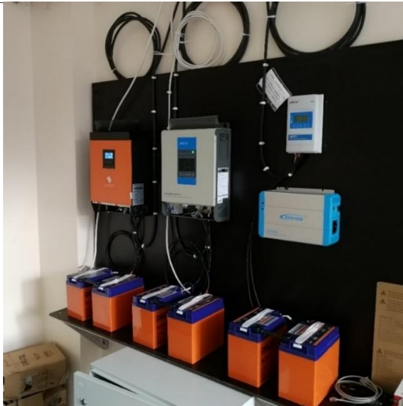
Рис. 2. Общий вид вспомогательного оборудования экспериментального стенда.
